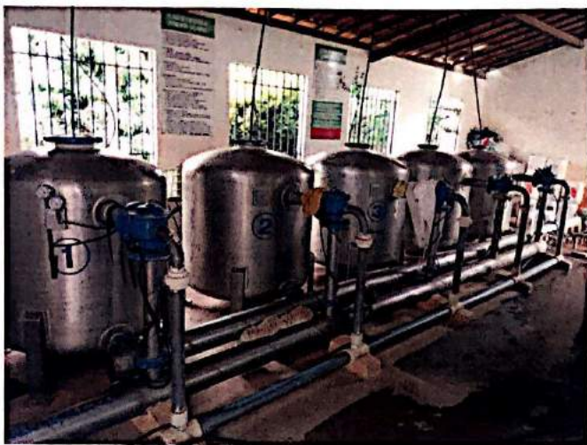
Fotografia 05 - Sistema de Filtragem de Água de Irrigação
