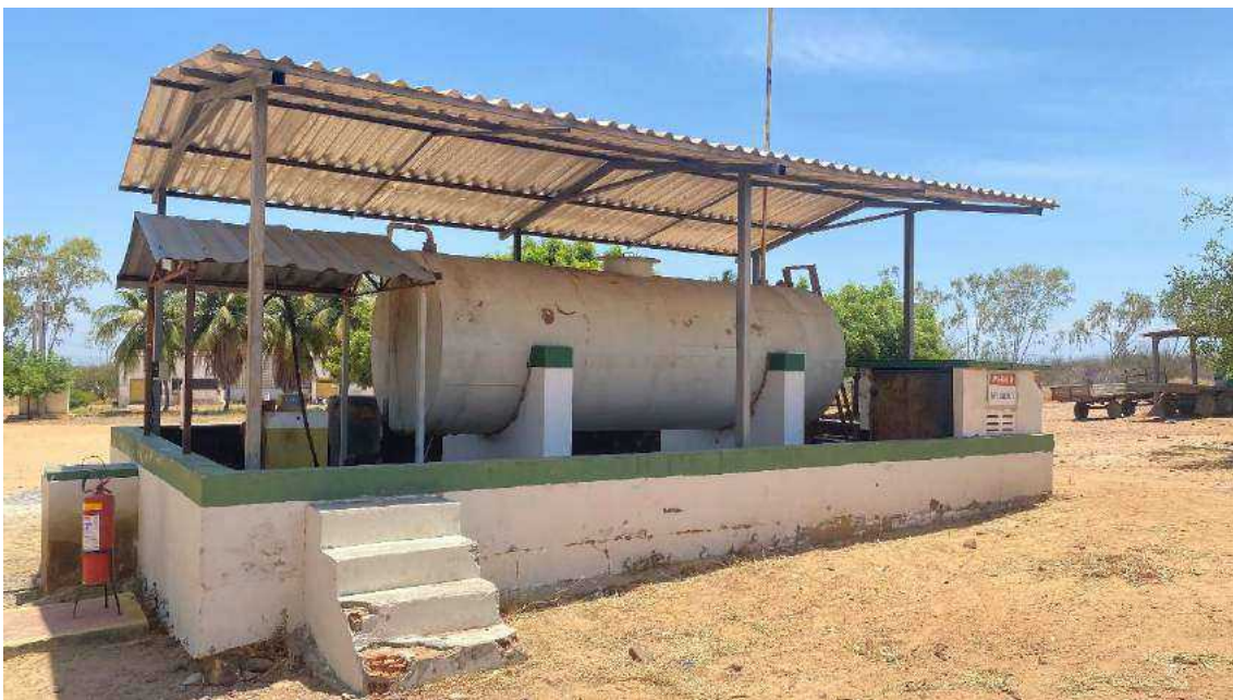
Foto 4: Tanque de armazenamento de combustível
