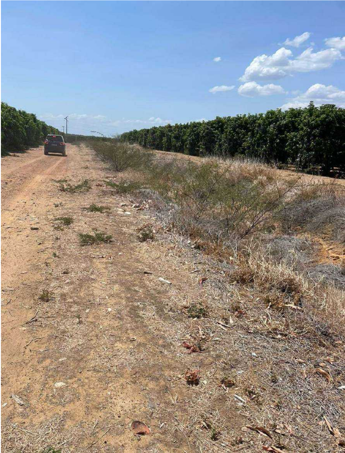
Foto 19: Dreno precisando de limpeza
