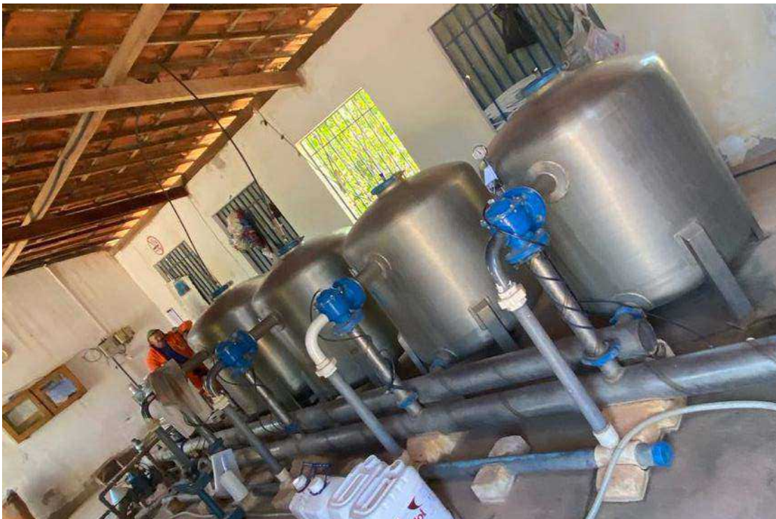
Foto 14: Casa de filtro 2
