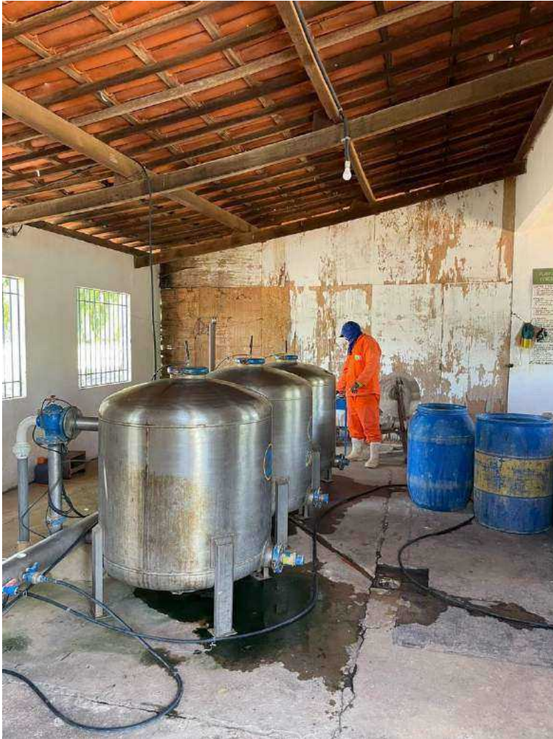
Foto 13: Casa de filtro 1
