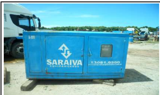
A109 - GRUPO GERADOR GERASTEP 2011
